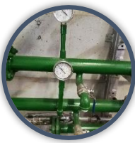
Redes de tubería
